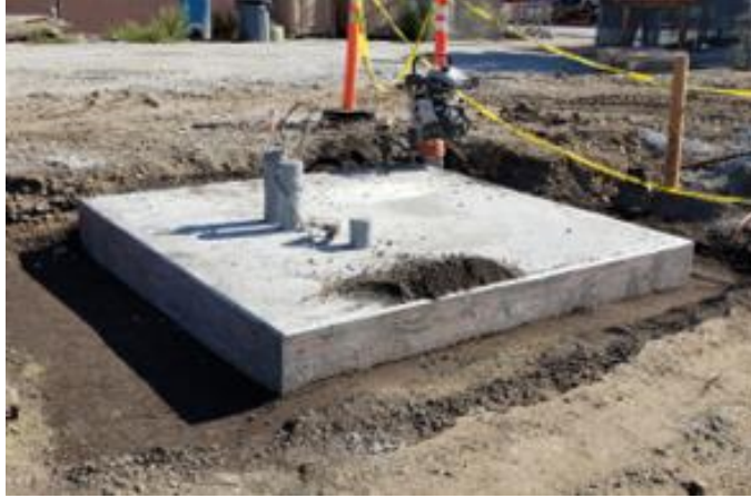
Poured PG&E Low Voltage Padat SWS-1
